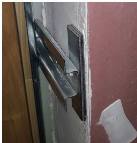
Nesprávná způsob podložení kotvicího profilu. *Není vymezena mezera mezi stěnou a kotvicím profilem v místě polodrážky zárubně.
